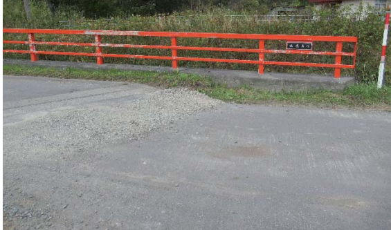
写真 4.1.20 取付部の段差
