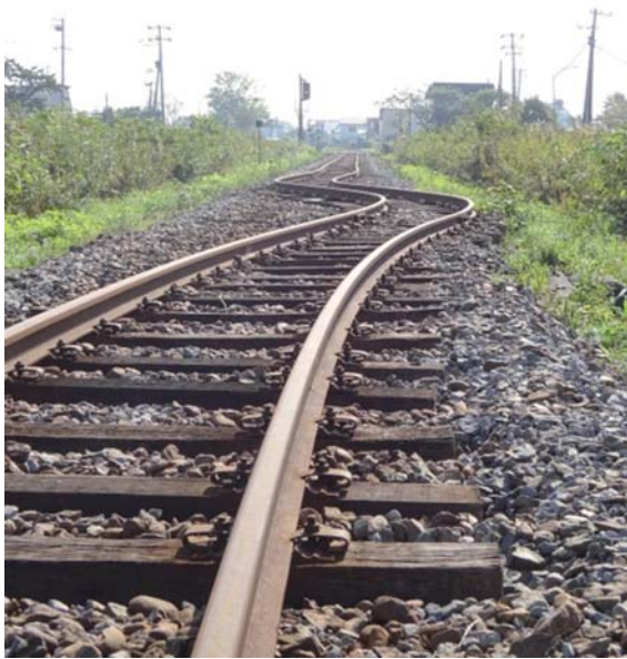
写真 7.3.1 鵜川駅西側の線路の蛇行
