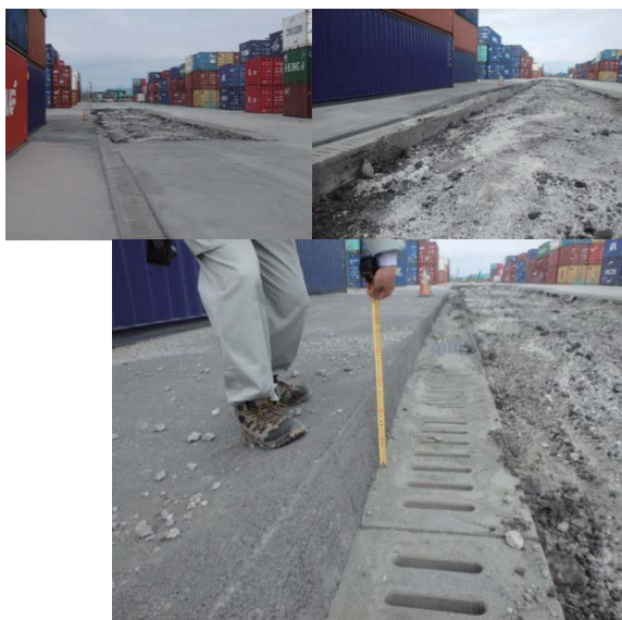
写真 6.1.17 ③排水溝や舗装の不同沈下と復旧状況
