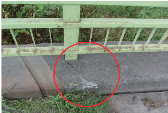
写真 4.1.12 地覆のクラック
