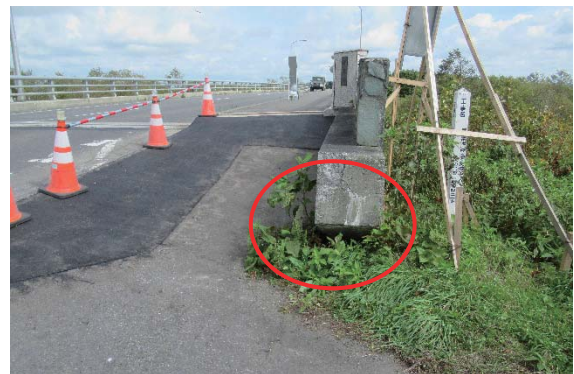
写真 4.1.15 橋台背面の沈下
