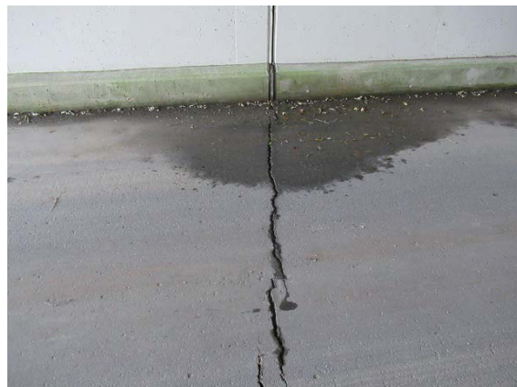
写真 4.2.19 路面のクラックと漏水跡(1)
