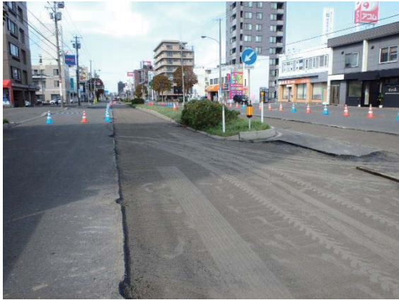
写真 3.3.1① 屯田通の被害状況(北 40 条付近)
