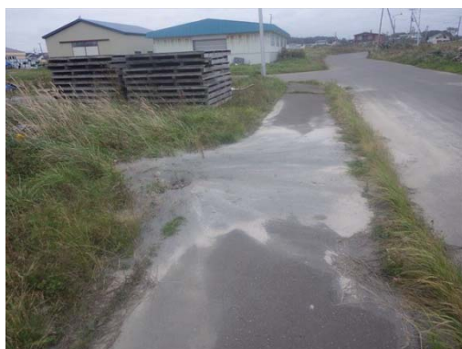
写真 6.2.1 道路と岸壁の段差（鵠川漁港）
