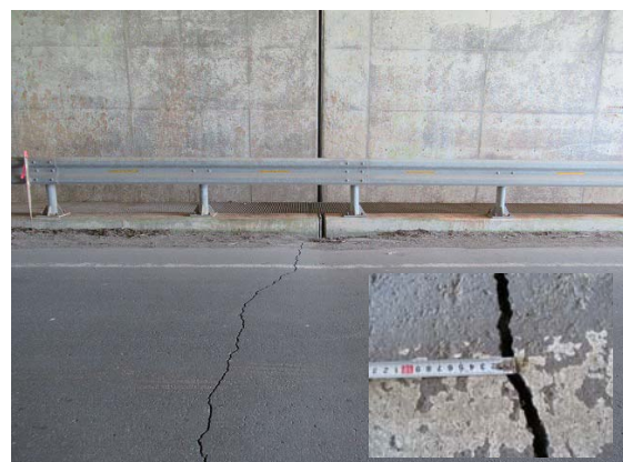
写真 4.2.14 目地位置の路面のクラック
