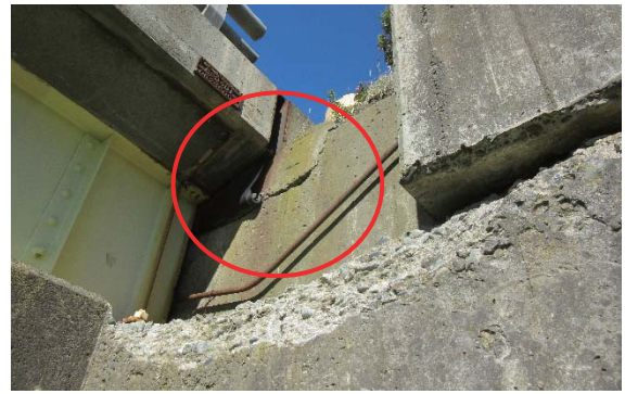
写真 4.1.28 橋台パラペットのひび割れ
