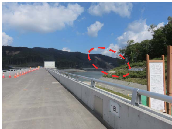
写真 5.2.11 厚幌ダム貯水池右岸斜面崩壊
