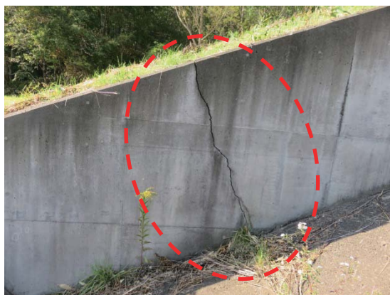
写真 5.2.18 ため池 洪水吐クラック
