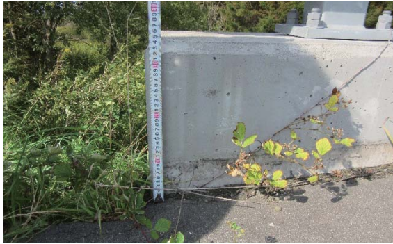
写真 4.1.6 橋台背面の沈下
