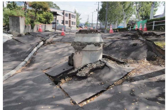
写真 3.2.1⑤里塚 1 条 突出した地下河川の マンホール
