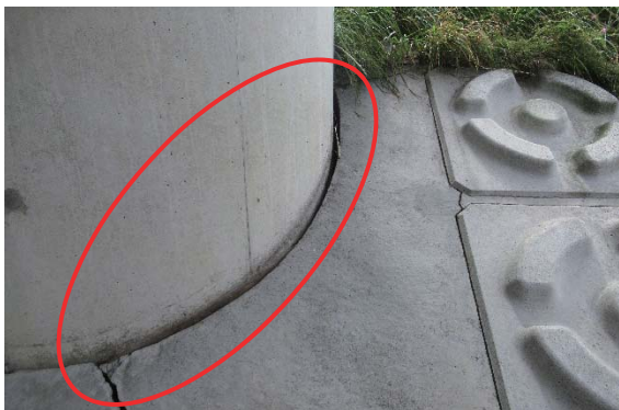
写真 4.1.8 橋脚基部と護岸との隙間
