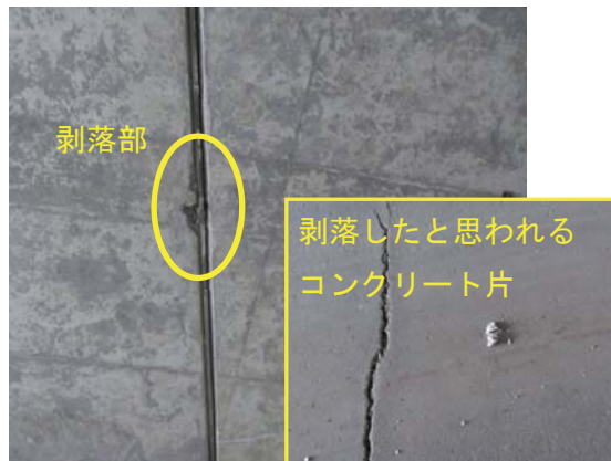
写真 4.2.21 頂版部の目地におけるコンクリートの剥落箇所
