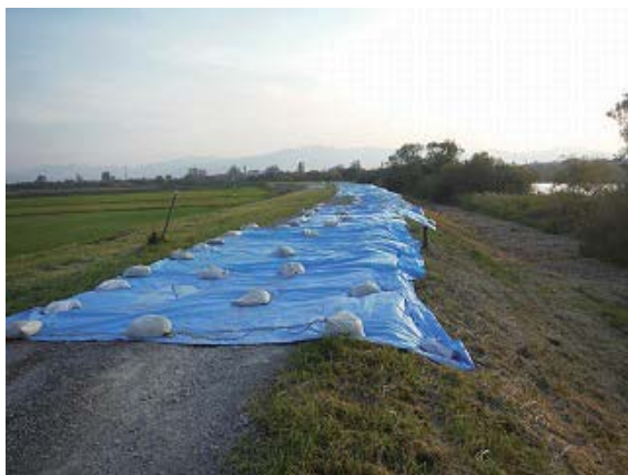
写真 5.1.7 茨戸川被害状況
