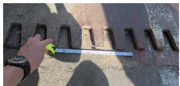
写真 4.1.30 ジョイントのずれ
