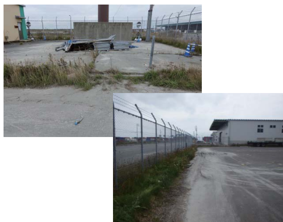
写真 6.1.20 ⑥敷地北東部の噴砂の状況
