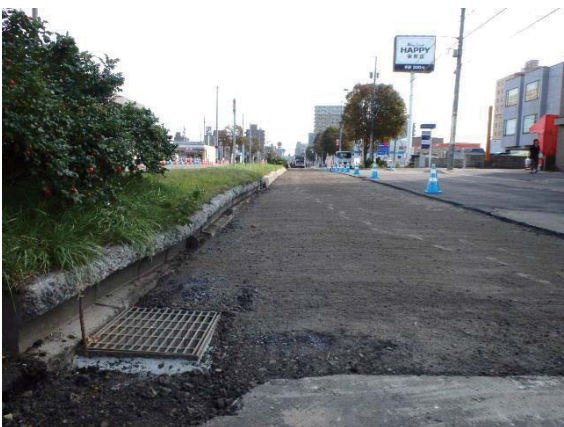
写真 3.3.1③ 屯田通の被害状況(北 40 条付近)
