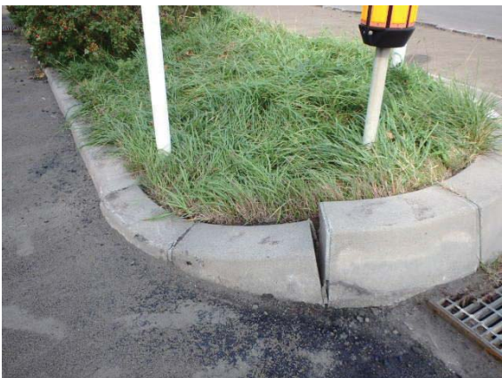
写真 3.3.1② 屯田通の被害状況(北 40 条付近)
