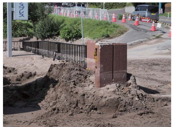
写真 3.2.1⑦里塚 1 条 下流に堆積した砂
