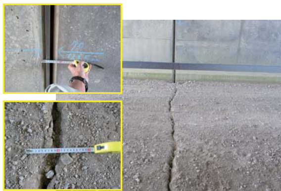
写真 4.2.7 目地位置の路面のクラック
