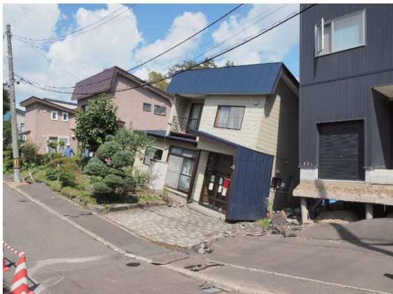
写真 3.2.1③里塚 1 条 陥没に伴い 沈下した住宅
