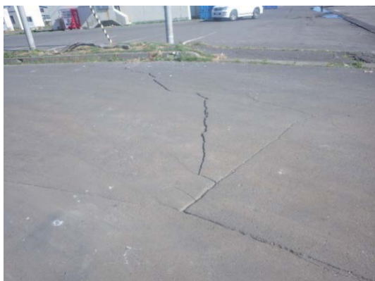
写真 6.2.8 富浜漁港（路面クラック）
