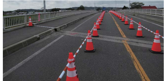
写真 4.1.23 鋼桁の橋軸直角方向のずれ
