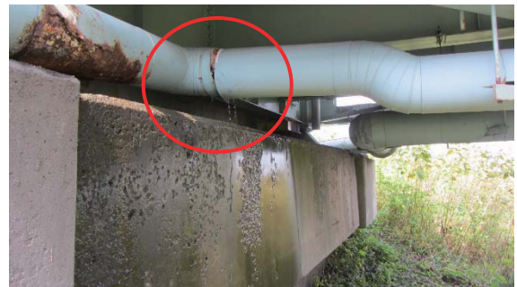
写真 4.1.10 排水管の破損 (漏水)
