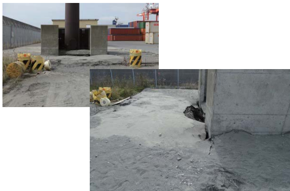
写真 6.1.15 ①照明柱基礎部の噴砂と陥没
