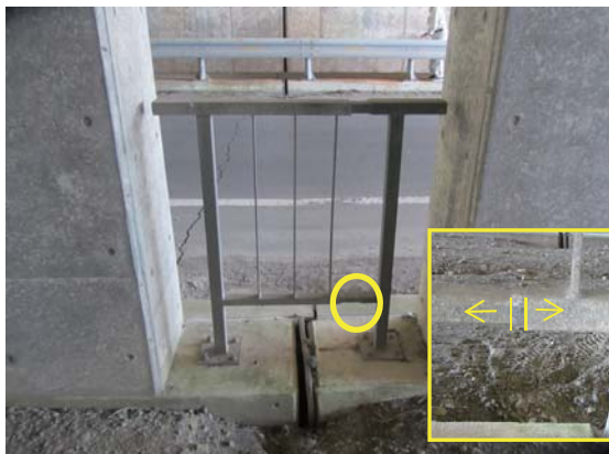
写真 4.2.16 目地位置の防護柵の変状(1)
