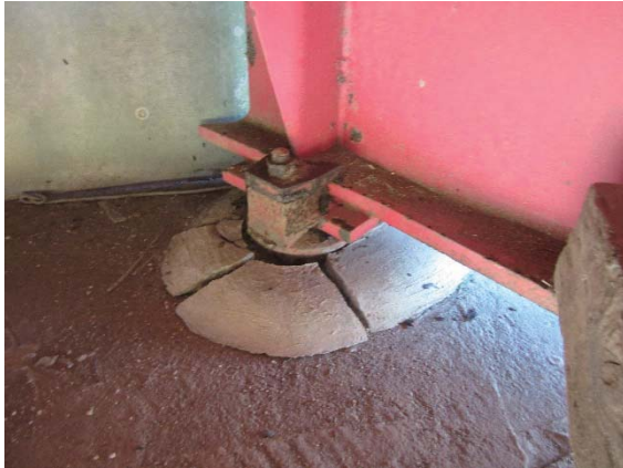
写真 4.1.26 沓座モルタルの破損
