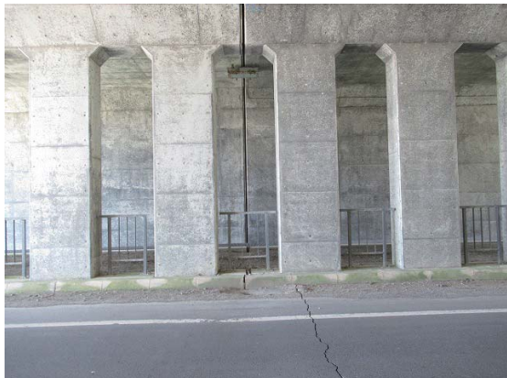
写真 4.2.15 目地位置の路面のクラック
