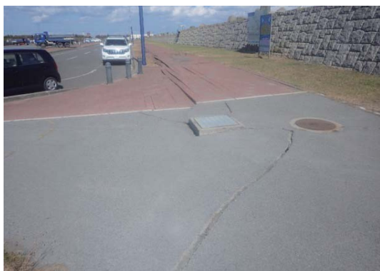
写真 6.2.7 勇払マリーナ（路面の段差）
