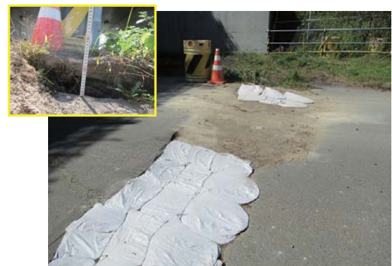
写真 4.2.9 路面の段差 (土嚢等による擦り付け復旧)
