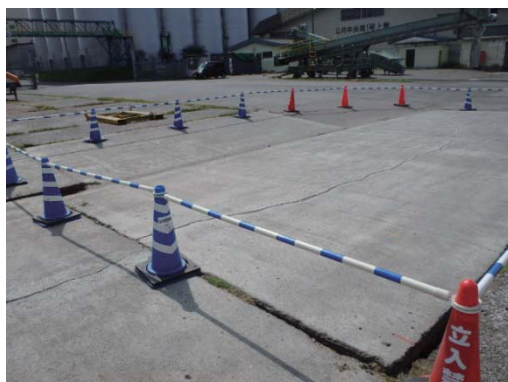
写真 6.1.8 エプロンの不同沈下
