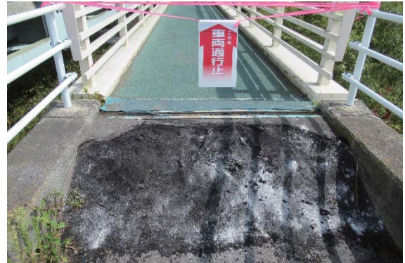
写真 4.1.11 取付部の段差
