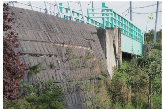
写真 4.1.35 擁壁のはらみ出し (A1 側)
