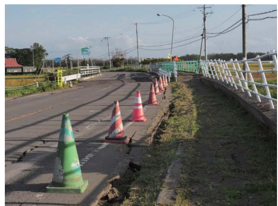
写真 4.1.36 取付盛土の沈下 (A1 側)
