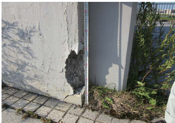
写真 4.1.1 主塔基部の破損
