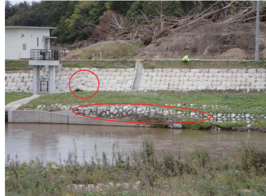
写真 2.2.25 護岸に見られる変状
