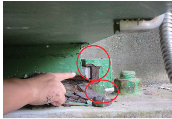
写真 4.1.14 固定支承ストッパーの破損
