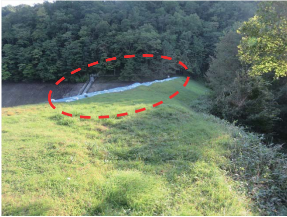
写真 5.2.4 クオーベツダム 堤体天端クラック
