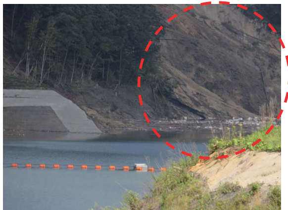
写真 5.2.12 厚幌ダム貯水池右岸斜面崩壊 (拡大)
