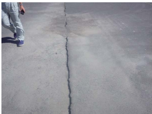
写真 6.2.9 門別漁港（噴砂及びクラック）
