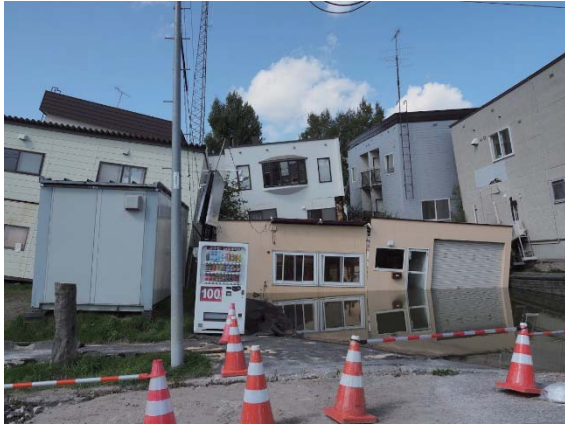
写真 3.2.1①里塚 1 条 陥没が最も大きく 残っていた場所
