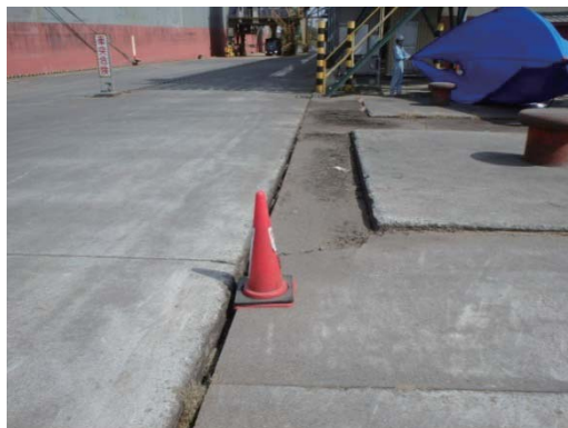
写真 6.1.9 エプロンの目開きと係船柱基礎の抜け上がり
