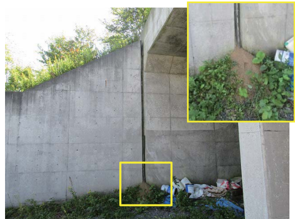
写真 4.2.2 坑口部の目地の土砂流出
