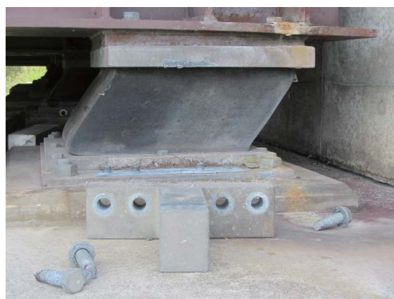
写真 4.1.18 サイドブロックの破損
