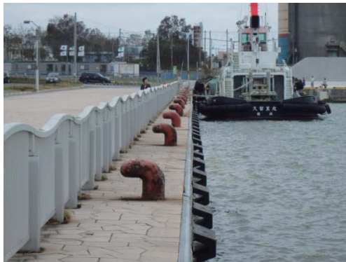
写真 6.1.3 北ふ頭の岸壁の状況
