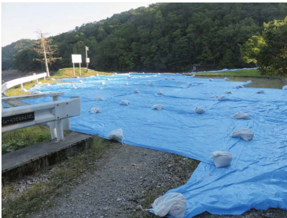
写真 5.2.5 クオーベツダム 駐車場クラック
