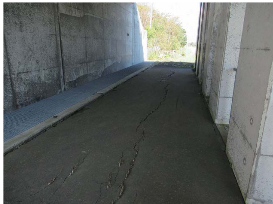
写真 4.2.11 路面のカルバート縦断方向のクラック（亀裂部に植物が自生）
