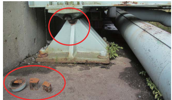
写真 4.1.9 ピン支承の破断
