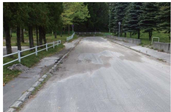
写真 3.2.2④ 清田区美しが丘の被害状況
