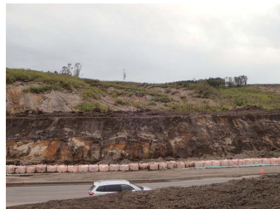
写真 2.2.2 道路上に堆積した崩積土と背後の崩壊地
