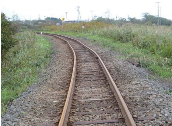
写真 7.3.2 浜厚真駅西側の線路のゆがみ
