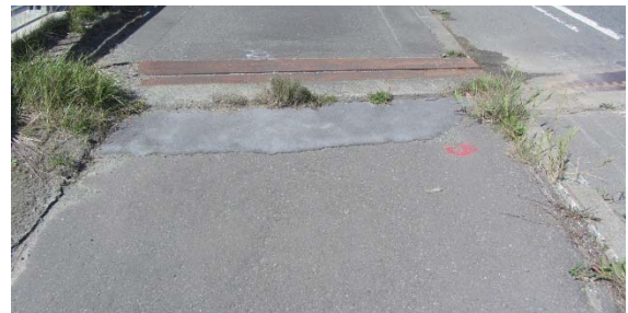
写真 4.1.25 取付部の段差
