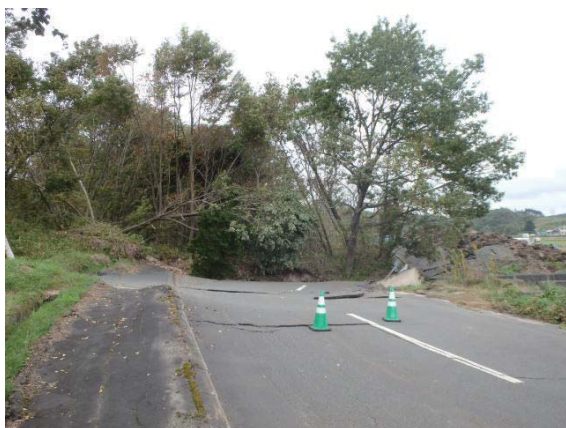
写真 2.2.8 斜面崩壊による道路閉塞の状況 (9月16日撮影)
