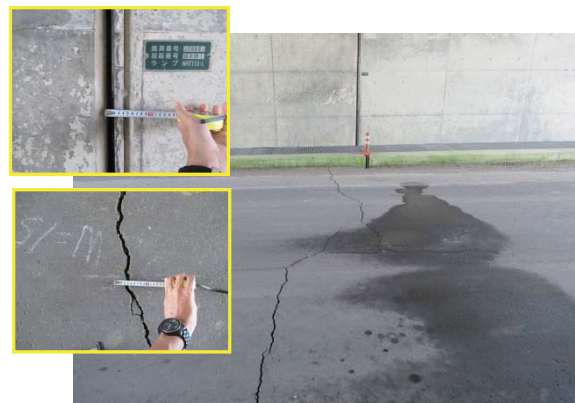
写真 4.2.3 目地位置の路面のクラック
