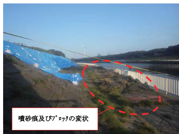
写真 5.1.6 右岸側被害状況(河口部右岸 0.1k)
