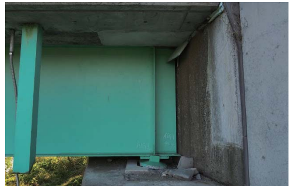
写真 4.1.34 桁と A2 橋台の衝突
