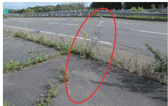
写真 4.1.5 取付部の段差
