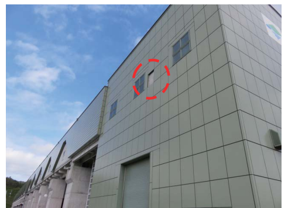
写真 5.2.14 二風谷ダム パネル落下
