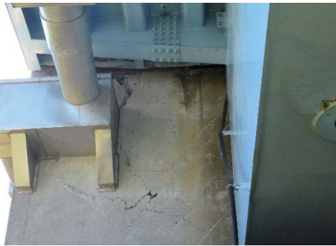
写真 4.1.31 橋台のひび割れ
