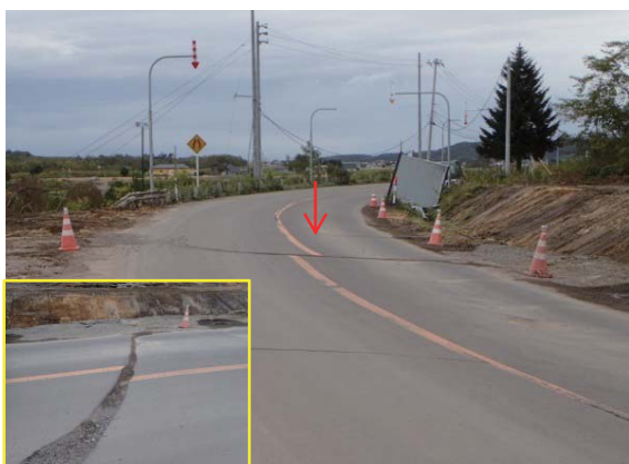
写真 2.2.12 崩壊地 A-1 道路を横断する亀裂（写真右側が崩壊斜面）
