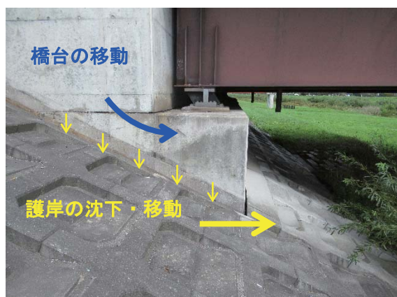
写真 4.1.17 護岸と橋台の移動
