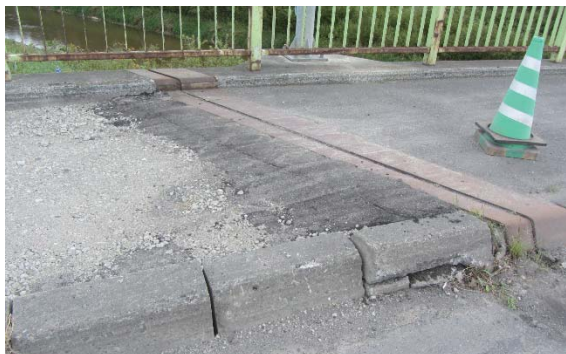
写真 4.1.13 取付部の段差
