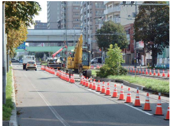
写真 3.3.2① 屯田通の被害状況(北 36 条付近)
