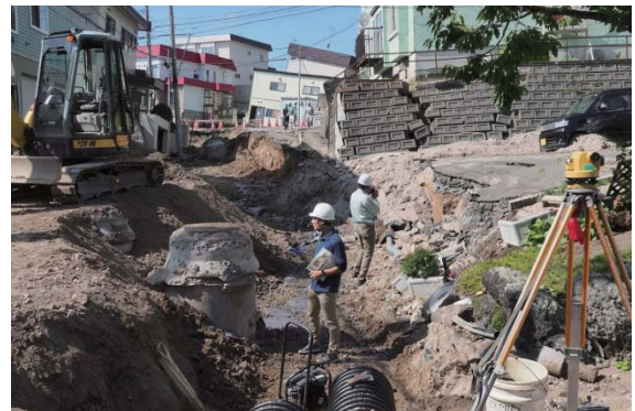
写真 3.2.1⑥里塚 1 条 この上部で水道管が 破裂、土砂が流出
