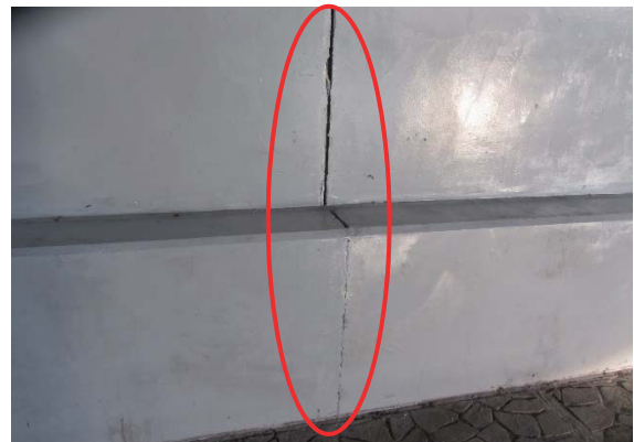
写真 4.1.4 橋脚目地の開き
