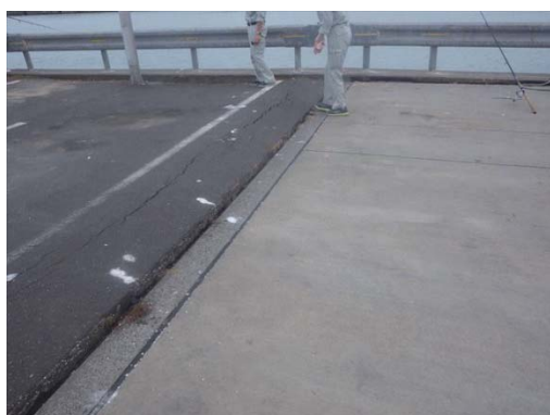
写真 6.2.2 道路と岸壁の段差（鵠川漁港）
