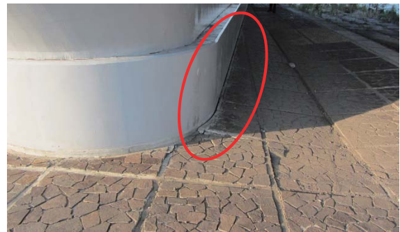
写真 4.1.3 橋脚基部の隙間
