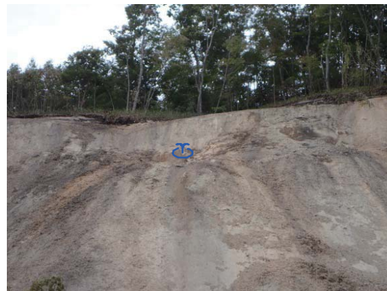
写真 2.2.14 崩壊地 A-2 上部の近景 滲み出し程度の湧水が見られる
