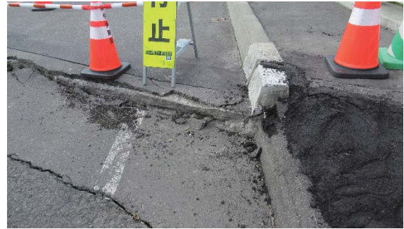
写真 4.1.22 取り付け部の段差
