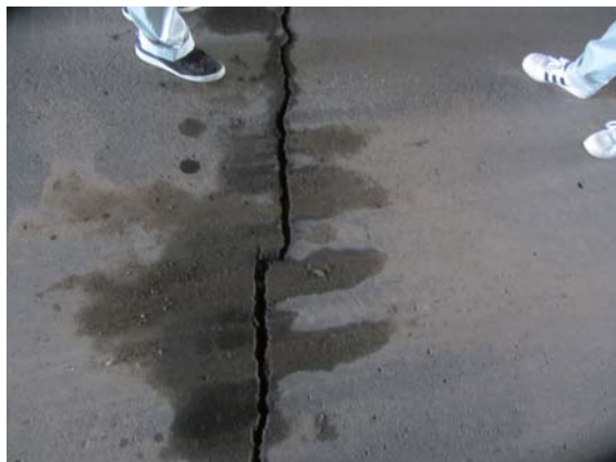
写真 4.2.20 路面のクラックと漏水跡(2)
