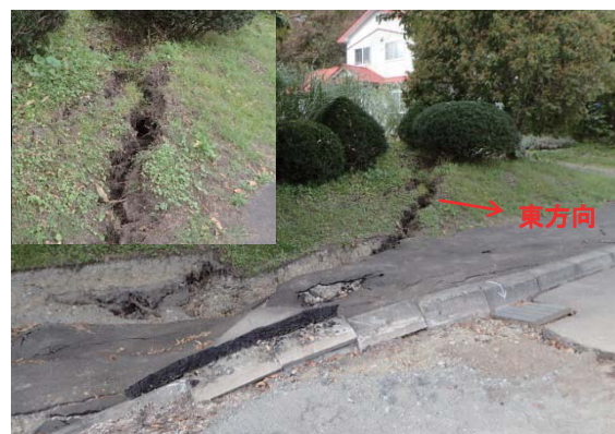
写真 2.2.6 崩壊地の東側に見られる亀裂 矢印方向に根が引っ張られている
