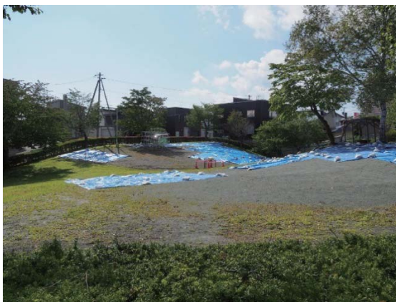
写真 3.2.1②里塚 1 条 中央が大きく陥没 した里塚中央ポプラ公園
