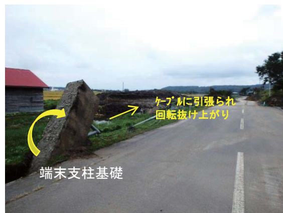
写真 2.2.7 端末支柱基礎の抜け上がり
