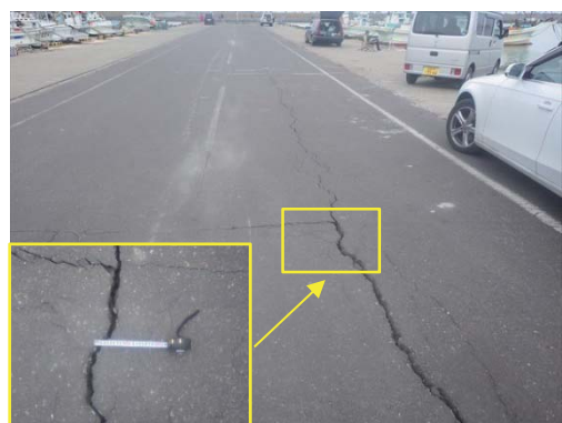
写真 6.2.3 路面のクラック（鵠川漁港）
