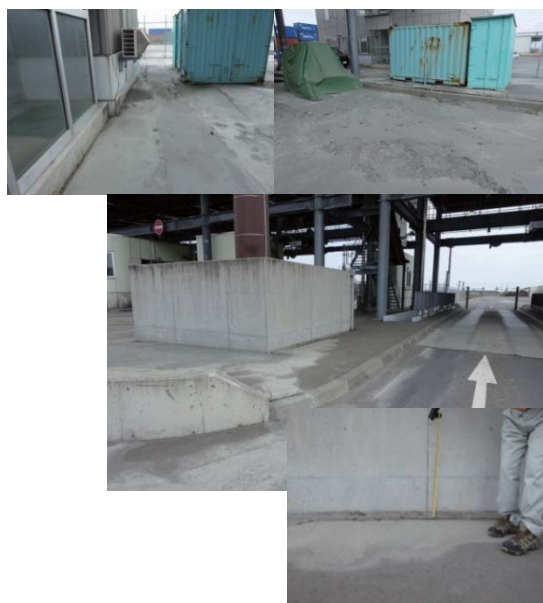
写真 6.1.19 ⑤管理棟及びゲートハウス周辺の噴砂と沈下
