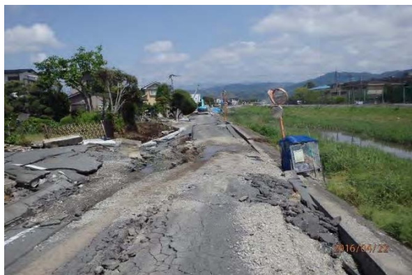
熊本市東区秋津川 堤防の沈下 (「2016年熊本地震地盤被害と復旧状況」清田他より抜粋)
