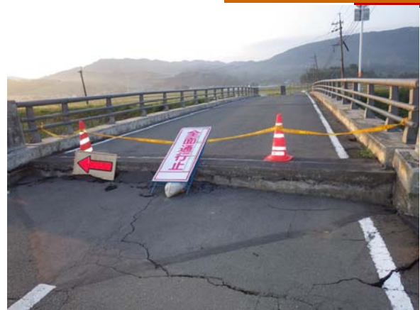
益城町 橋梁背面盛土の沈下
