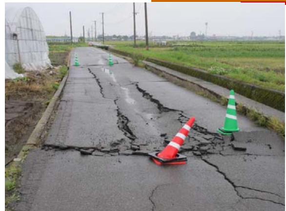
熊本市西区中原町 路面陥没(管渠埋め戻し土?)
