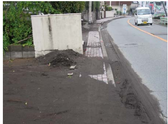
熊本市南区 噴砂と塀の不動沈下
