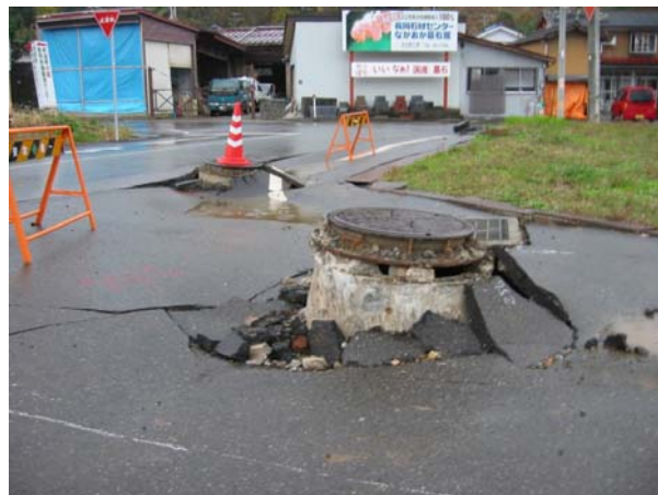
新潟県中越地震長岡市 人孔の浮き上がり
