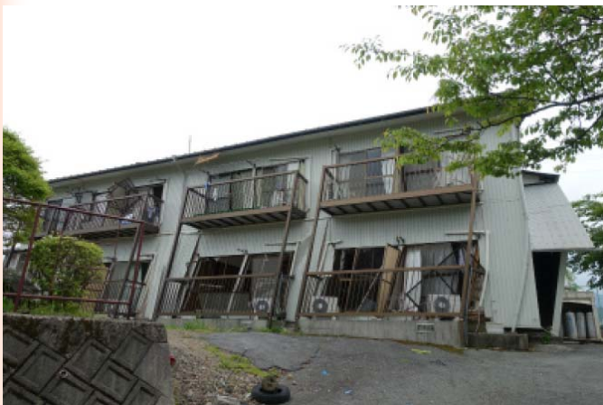
南阿蘇村 木造アパートの傾斜
