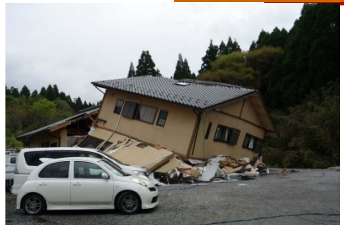
南阿蘇村 木造住宅の倒壊
