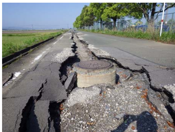
益城町 下水道管路部の路面陥没
