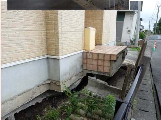
熊本市東区秋津町 住宅の地盤沈下
