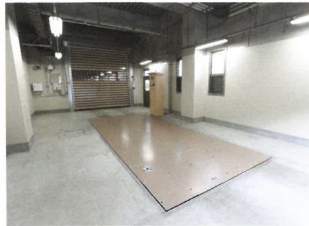
■搬入し尿等計量装置
