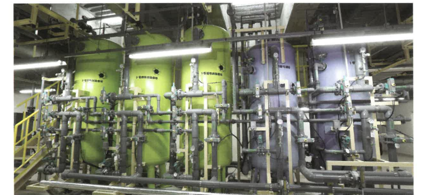
■砂ろ過塔・活性炭吸着塔
