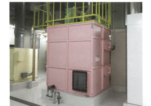
■中濃度臭気活性炭吸着塔
