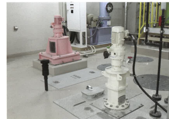
■凝集沈殿設備
