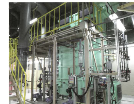
■薬品洗浄塔・アルカリ次亜塩素酸洗浄塔
