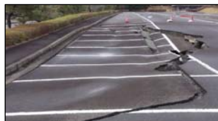
写真4 駐車場の側方流動
