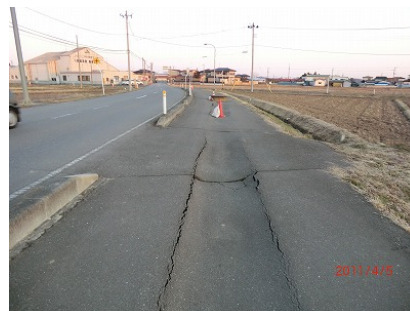
写真6 液状化による路面沈下 (宮城県栗原市内)
