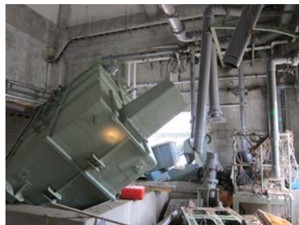
写真9 蛸の浦浄化センター内部被災状況
