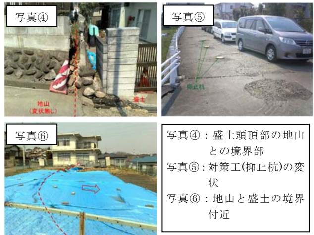
写真2 対策済造成地盤の被害状況(緑ヶ丘地区)
