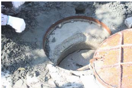
写真3 液状化による人孔の閉塞 (千葉県浦安市内)
