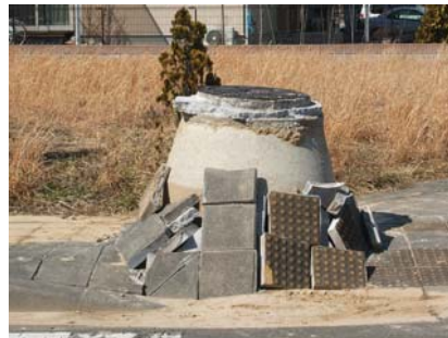
写真5 液状化による人孔の隆起 (宮城県白石市内)
