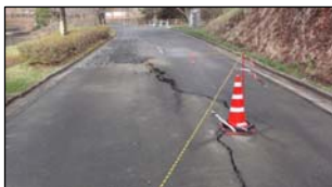
写真3 園路のクラック
