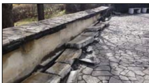
写真5 小端積の倒壊
