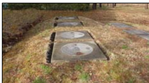
写真1 浄化槽の浮き上がり
