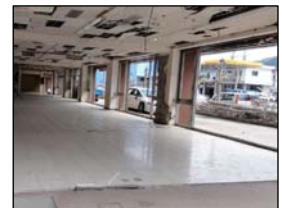
写真32 津波避難ビル1Fの被災状況
