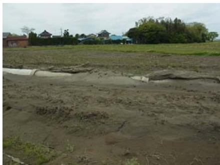
写真4 液状化による管路の浮上 (茨城県内)
