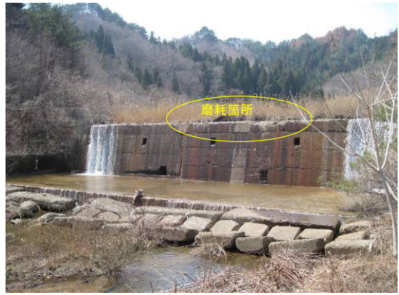
写真13 長内川 河口から1.5km地点の床固工の状況 (流水による磨耗あり)
