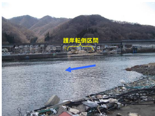
写真1 甲子川 護岸転倒状況
